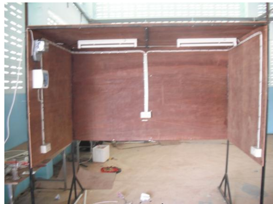
รูปที่ 3 แสดงชุดสาธิตการติดตั้งระบบไฟฟ้าในอาคาร
